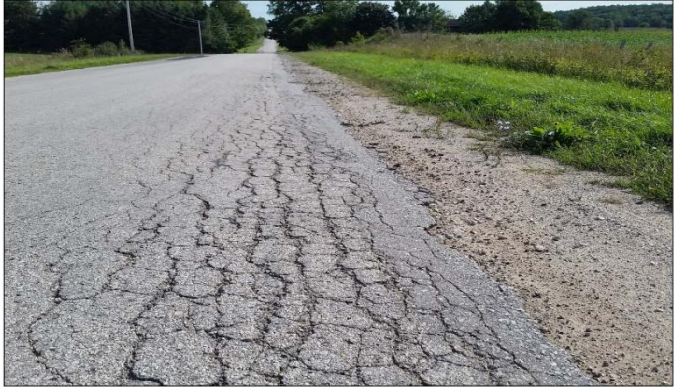
Edge alligator cracking
